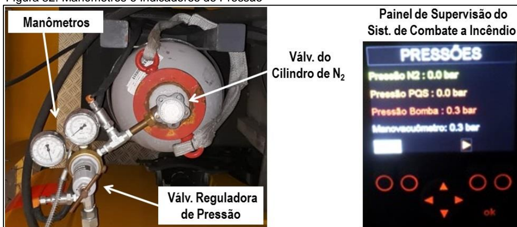
Figura 82: Manômetros e Indicadores de Pressão
