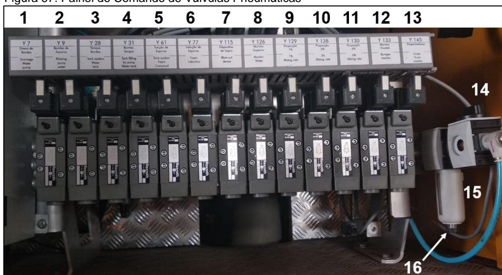
Figura 67: Painel do Comando de Válvulas Pneumáticas
