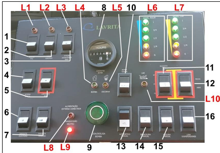
Figura 25: Painel de Comandos dos Sistemas de Combate a Incêndio
