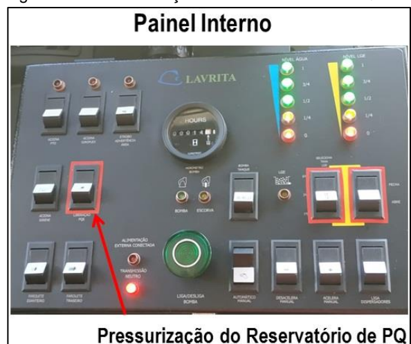
Figura 113: Pressurização do Reservatório de PQ
