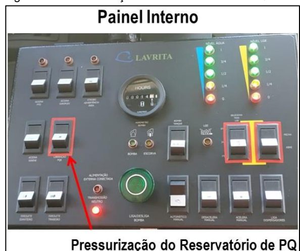
Figura 89: Pressurização do Reservatório de PQ
