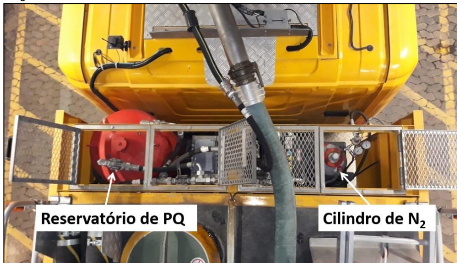
Figura 79: Reservatório de PQ
