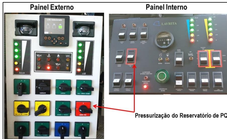
Figura 86: Pressurização do Reservatório de PQ
