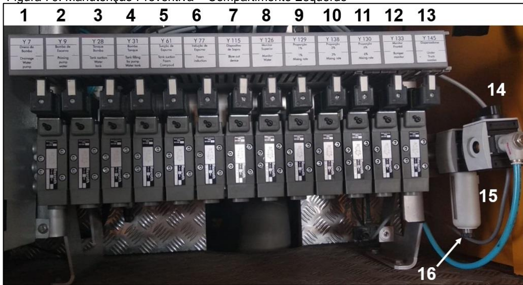
Figura 70: Manutenção Preventiva – Compartimento Esquerdo
