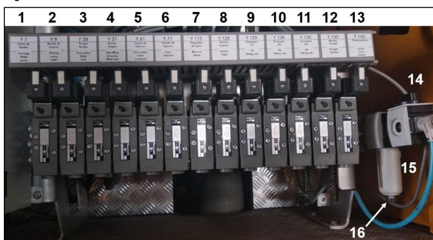
Figura 119: Bloco de Válvulas Pneumáticas
