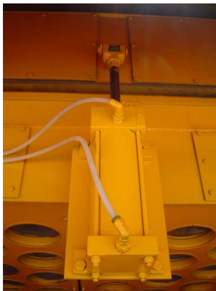
Registro do compartimento de filtragem - aberto
